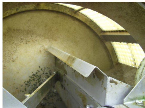
Figuur 7 Detail trommelfilter
